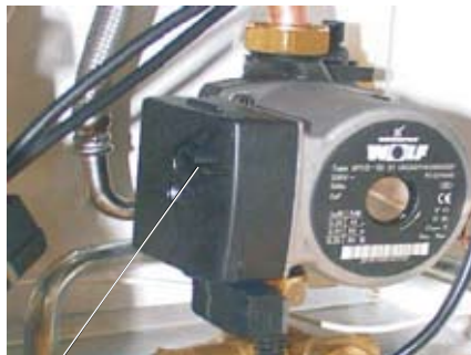
prepínač stupňa čerpadla
