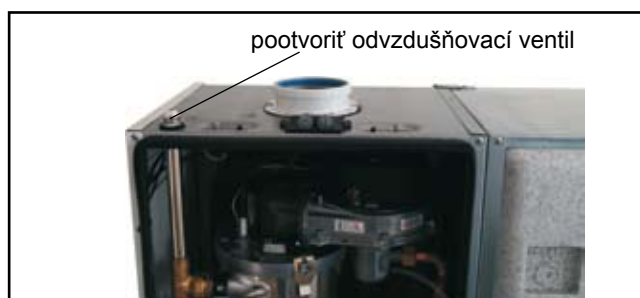
pohľad na ručný odvzdušňovací ventil
